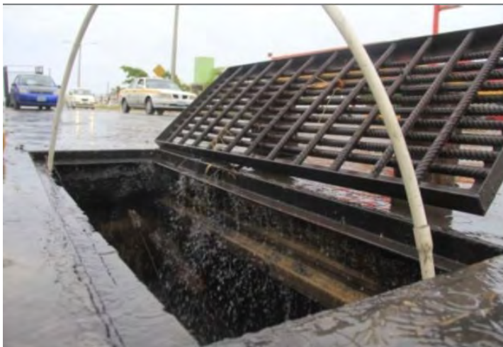
Fig. 19. La Jornada maya Deficiente sistema de drenaje de Tulum, (2018).
