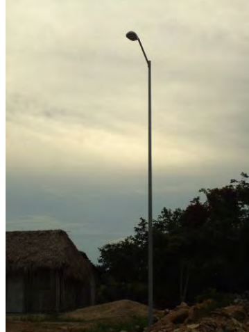
Fig.3.45 Poste metálico de 9 metros
