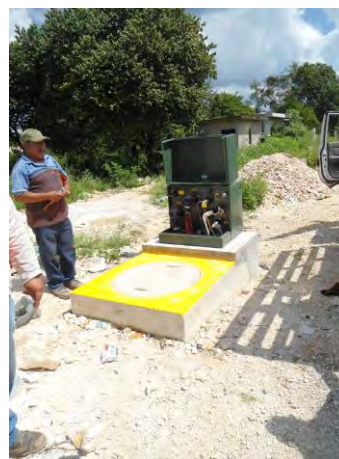
Fig. 3.35, base de transformador
