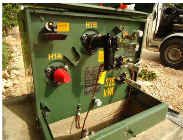
Fig. 3.10 Transformador tipo pedestal.
