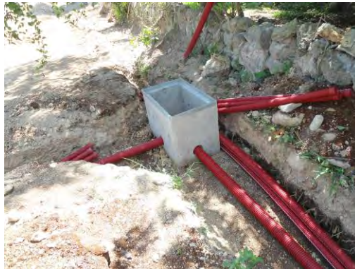
Fig.3.39 ducto de PAD corrugado
