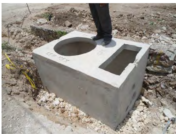
Fig. 3.34, base de transformador
