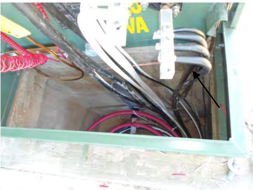
Fig. 3.24, transformador tipo pedestal
