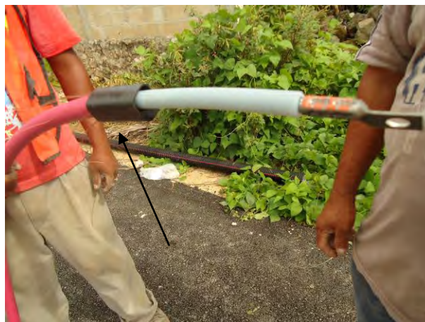
Fig. 3.6 Terminales tipo exterior de 15 kV.
