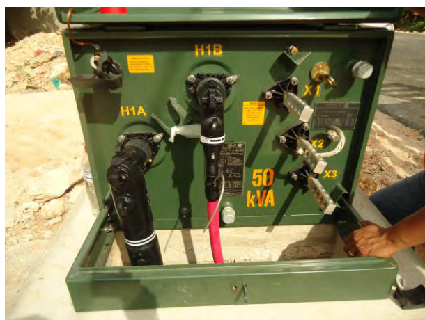
Fig. 3.9 Transformador tipo pedestal.
