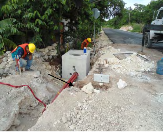
Fig. 3.22 ducto de tres vías para M.T.
