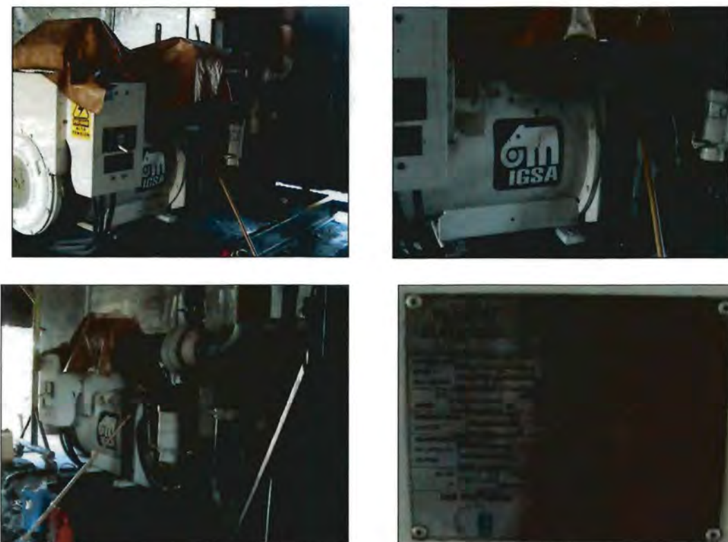
Figura 3. Imágenes del motogenerador de 250 kW y dato de placa técnica.
