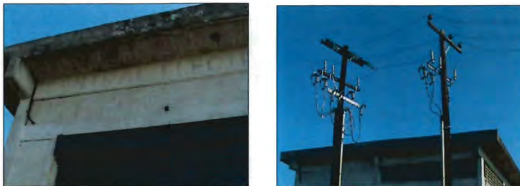
Figura 2. Central eléctrica de la comunidad.
