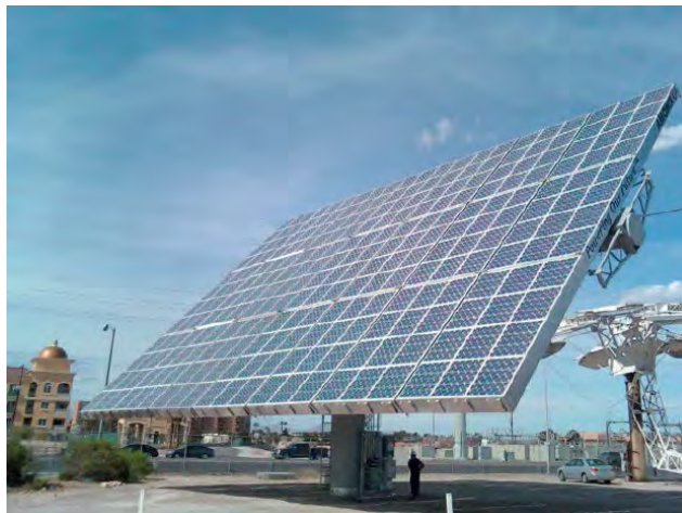
Fig. 14 Imagen de un generador fotovoltaico de 53 kW p en las Vegas USA
