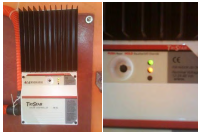
Figura 37. Fotografía del controlador con carga de 60% a 80%.
