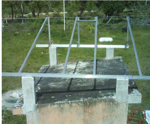
Figura 28. Fotografía del soporte de los módulos fotovoltaicos.
