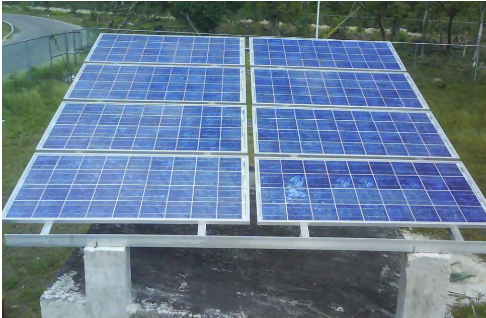
Figura 30. Fotografía de Módulos fotovoltaicos instalados en la estructura.
