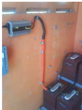
Figura 39. Conexión baterías a inversor.
