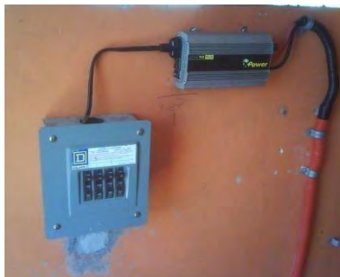
Figura 41. Fotografía Conexión inversor a centro de cargas.
