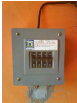
Figura 43. Fotografía centro de cargas, control de luminarias.
