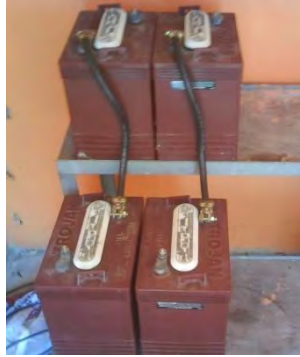
Figura 38. Fotografía de baterías conectadas en serie.
