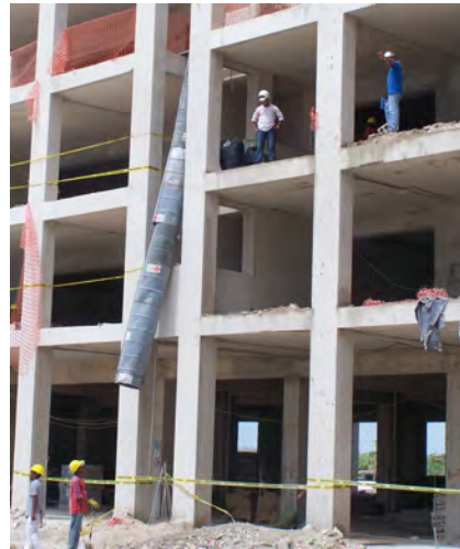
Figura IV.2. Medida instrumentada. Tubos conductores.
