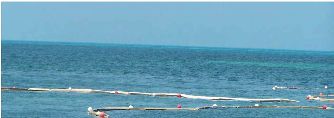
Figura IV.10. Sistema de malla geotextil a fin de retener la dispersión de finos hacia las áreas circundantes.
