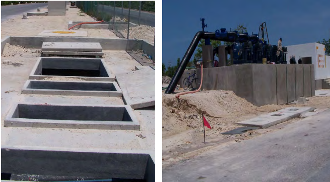
Figura IV.23 Infraestructura para el tratamiento de aguas residuales
