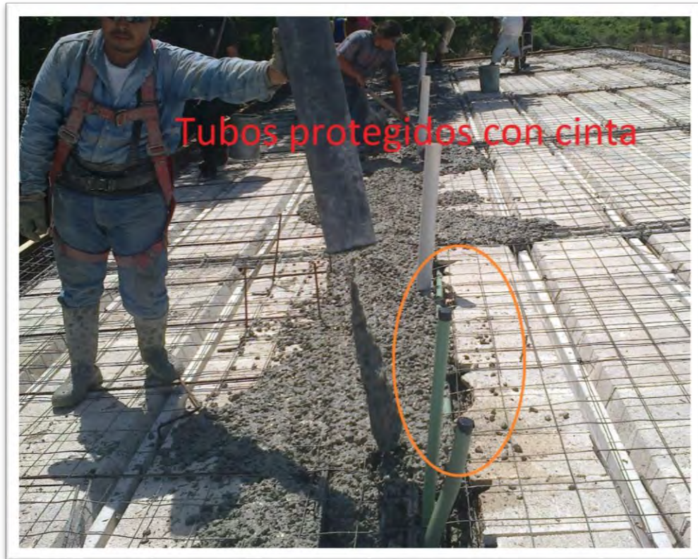
Figura 2.10. Fotografía de las puntas de las canalizaciones protegidas con cinta aislante.
