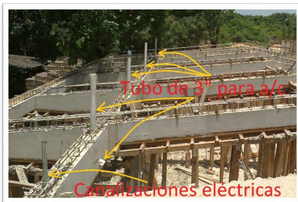
Figura 2.2. Fotografía. Ubicación de los tubos de los acondicionadores de aire.
