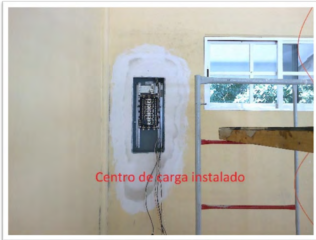
Figura 2.8. Fotografía del centro de carga instalado.
