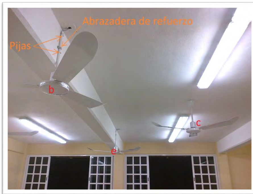
Figura 2.11. Fotografía de los ventiladores instalados.
