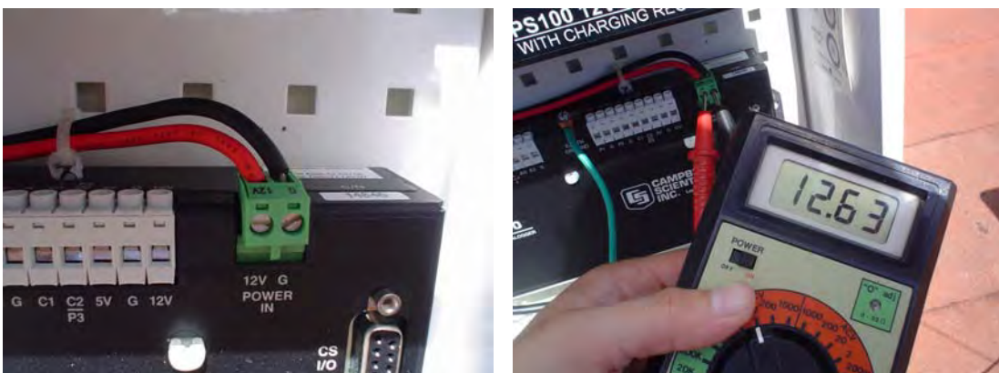
Figura 70. Conexión de la batería hacia el adquisidor de datos.
