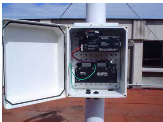
Figura 66. Instalación del adquisidor de datos en la Base 2.
