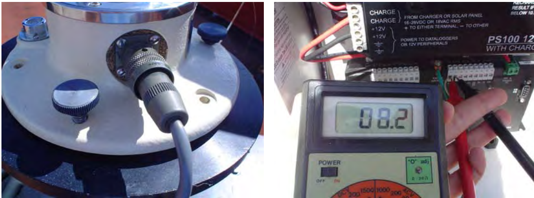
Figura 68. Conexión del piranómetro al adquisidor de datos.
