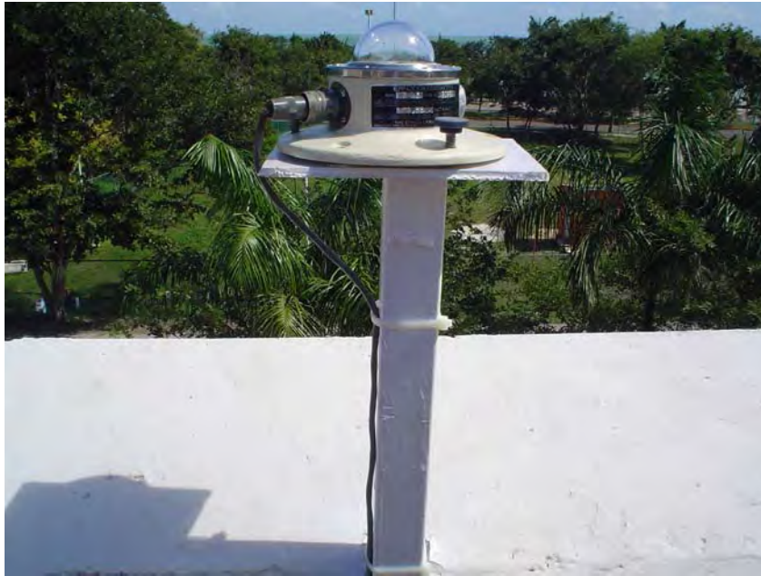
Figura 71. Armado final de la estación Solarimétrica, radiación directa (BASE 1).
