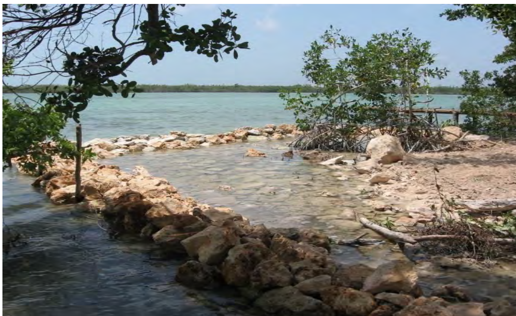
Fig. 15 Muro de Contención no autorizado. (29 de agosto del 2008)
