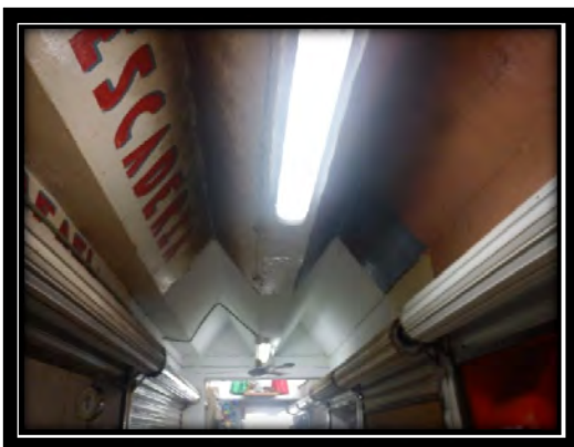
Fig. 9. Aluminado instalado en el área de marisquería.
