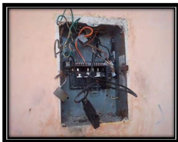
Fig. 26. Centro de carga peligroso ubicado en el pasillo exterior del mercado.
