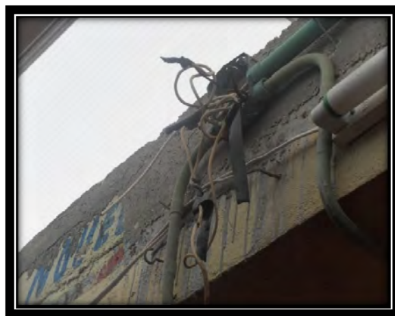
Fig. 29. Registro eléctrico ubicado en la parte superior del área de loncherías.
