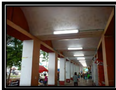
Fig. 8 Aluminado instalado en el área de pasillos exteriores del mercado, encendidos a plena luz del día.
