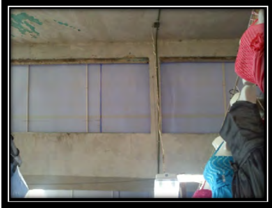
Fig. 36. Techo tapado con lonas pasillo 3
