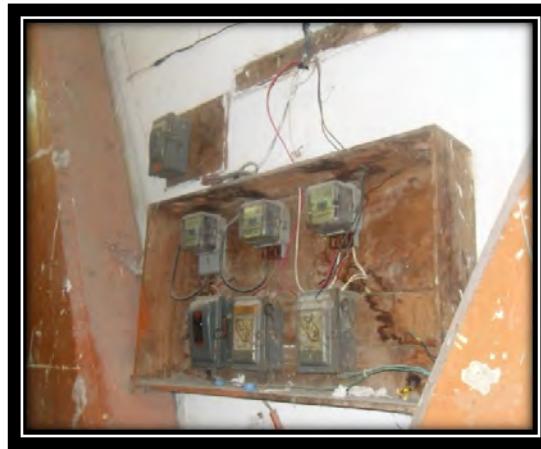
Fig. 21. Base de centros de carga y medidores ubicados en el interior del mercado el cual es inflamable.
