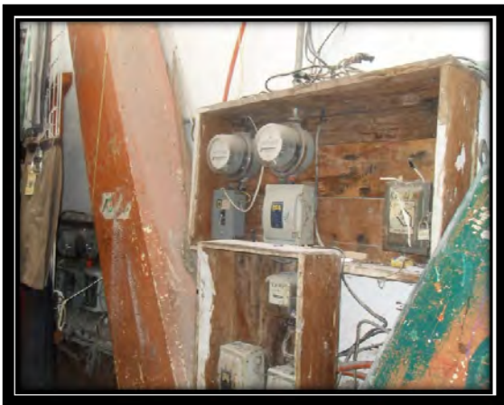
Fig. 20. Base de centros de carga y medidores ubicados en el interior del mercado el cual es inflamable.
